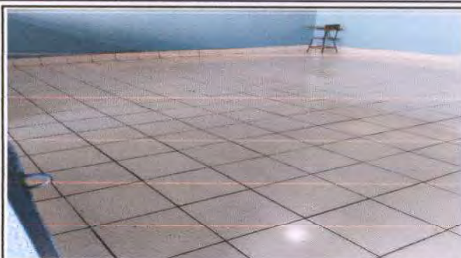
Foto 20: En aula 3, se colocará piso cerámico debido al deterioro del piso liso. Total de metros 51.5 m².
