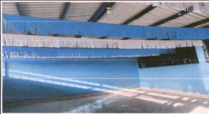
Foto 13: Pintura de aula 1, se pintará debido al tiempo y falta de pintura en algunos segmentos de la pared. Total de metros 98.33 m 2
