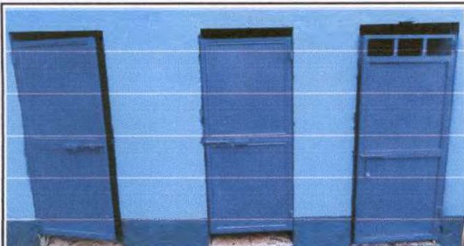
Foto 25: Mantenimiento a 3 puertas de los baños por deterioro en pintura y estructura. Medidas de las puertas 1.46 m de altura por 0.63 m de ancho.
